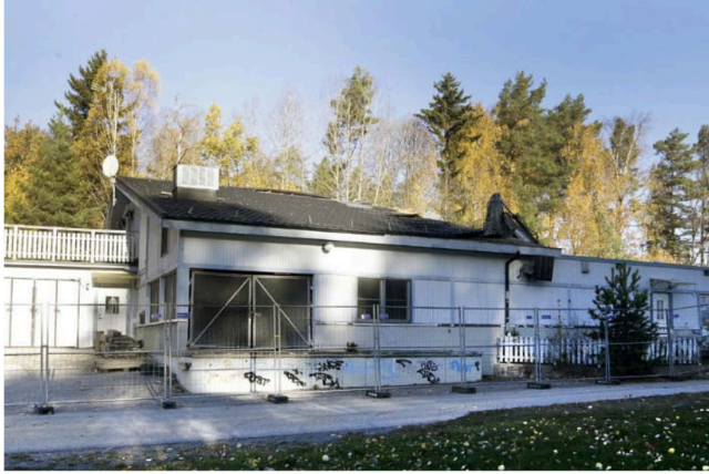
Sista väggen på Solbacka krog revs nyligen. Om några månader kommer det att stå en ny byggnad på samma plats, men med ett helt annat innehåll.
